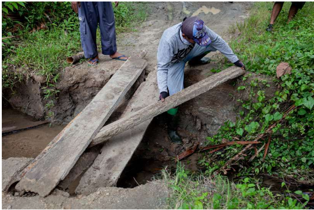
Pengojek terkadang harus turun untuk memperbaiki jembatan kayu yang rusak. Ojek drivers sometimes have to get off their motorbike to repair the damaged wooden bridge.
